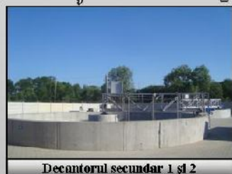
Decantorul secundar 1 și 2
