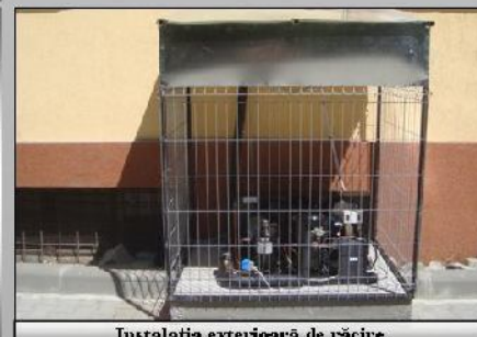
Instalația exterioră de răcire
