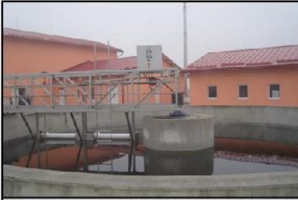
Decantor secundar de la stația de epurare Huedin
