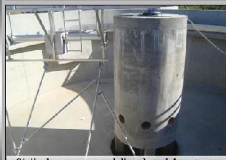
Stația de epurare - unul din cele trei decantatoare
