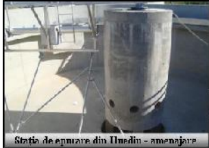
Stația de epurare din Huedin - amenajare
